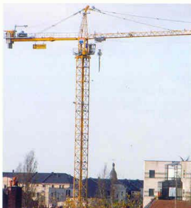
En Grande Bretagne, une norme impose que le levage soit préparé, planifié, supervisé par une personne qualifiée qui contrôle totalement l'opération.
